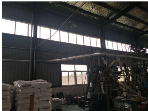
印刷区集气总管
