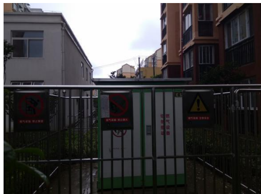
小区燃气设备
