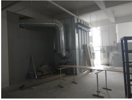
木工车间脉冲布袋除尘装置
