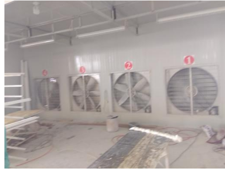
底漆打磨车间排风装置
