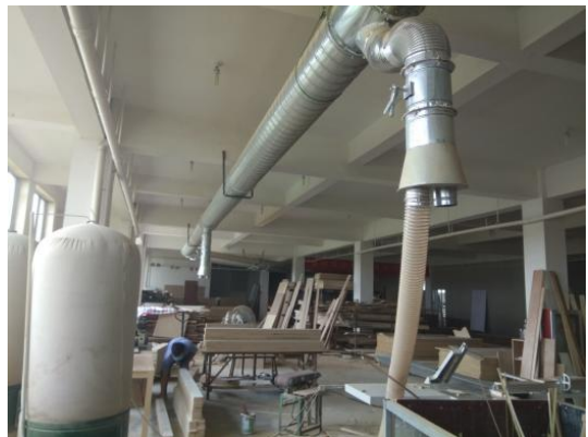
木工车间集气总管
