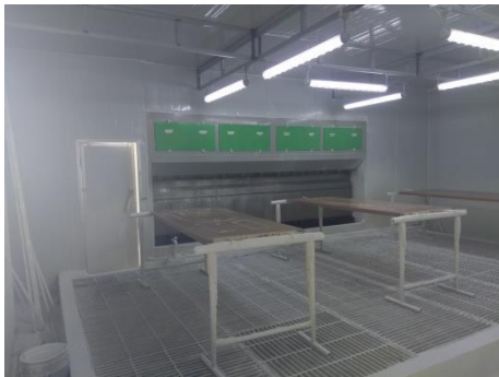
喷漆房水帘装置 1
