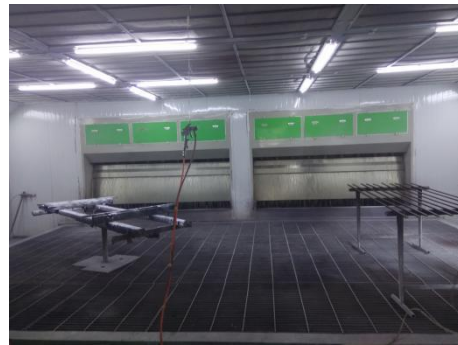
喷漆房水帘装置 2
