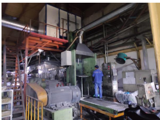
车间内集气装置
