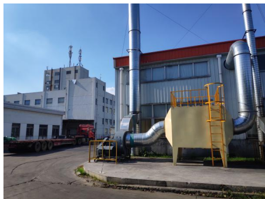
废气处理设施
