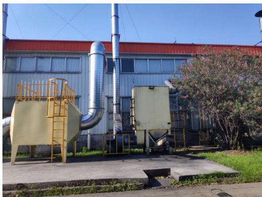
废气处理设施
