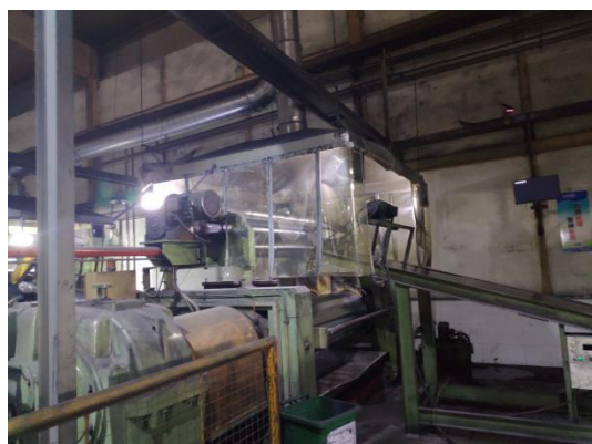
车间内集气装置
