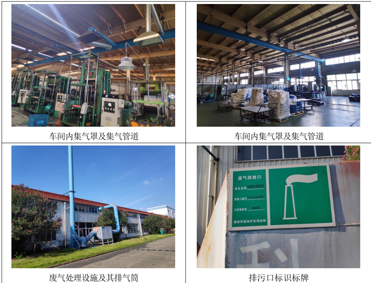
图 4-3 废气处理设施照片
