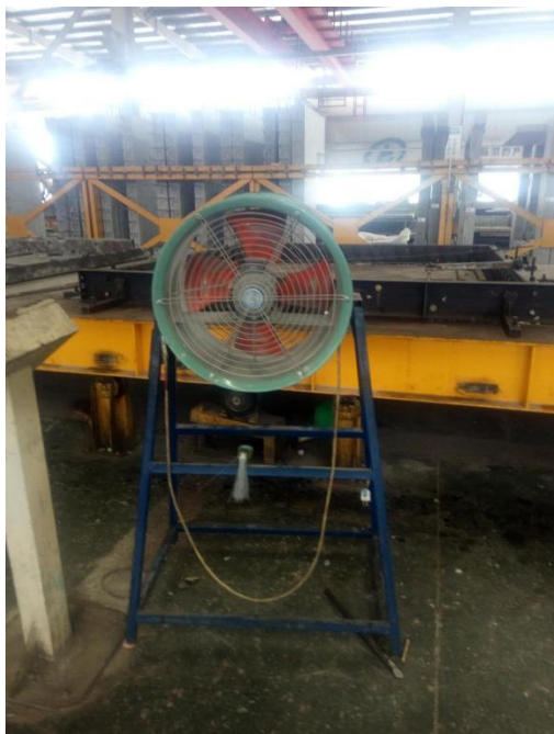
车间地面通风装置
