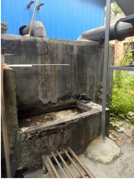
水膜除尘设施
