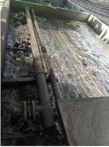
污水处理设施
