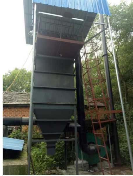
布袋除尘设施
