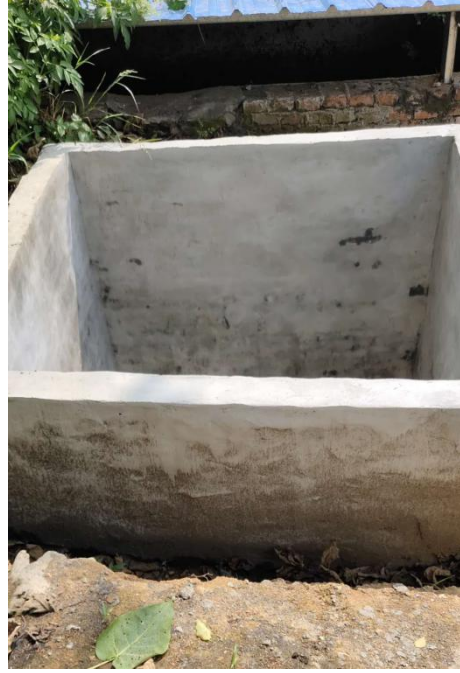
预留污泥收集池
