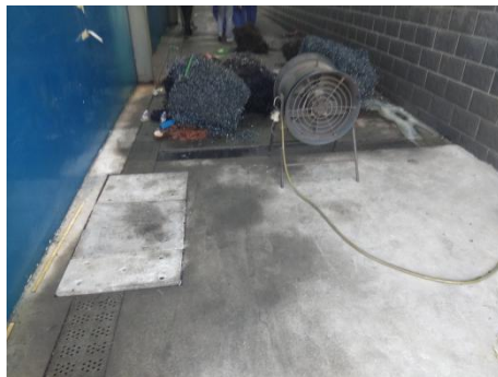
固废暂存区围堰、收集池
