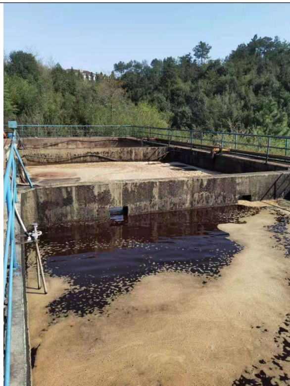
硝化池+碳化池+反硝化池
