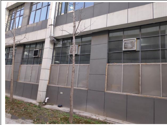
车间通风装置
