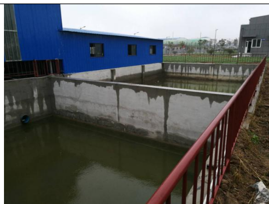
事故池、雨水池
