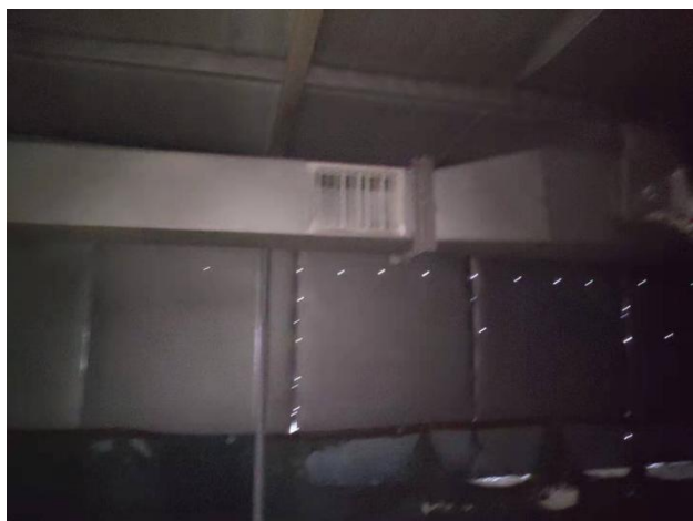
抛丸车间集气管道
