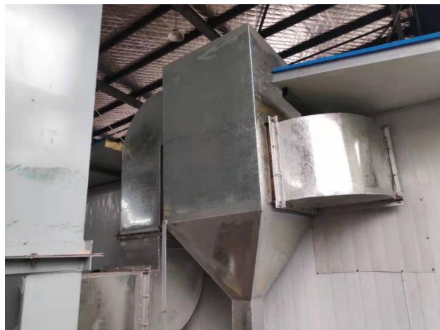
废气处理设施
